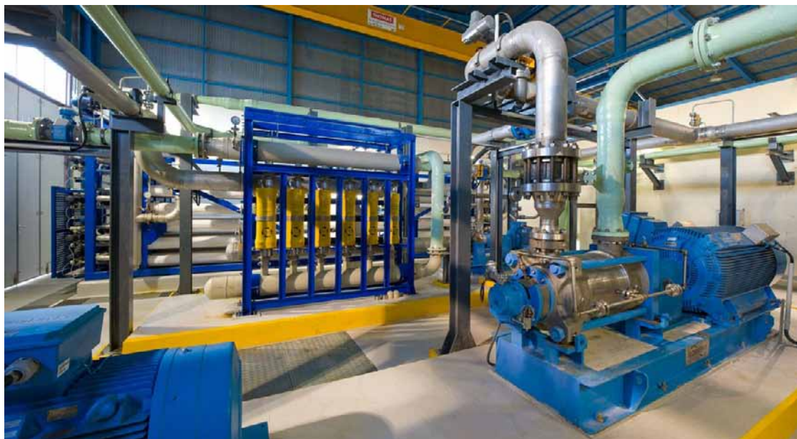
Interior de la desaladora de Ibiza.
