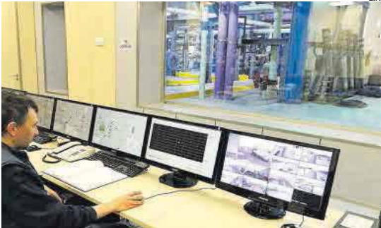
Instalaciones de la desaladora de Eivissa.
